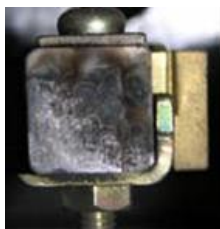
接触不良を起こしている状態
